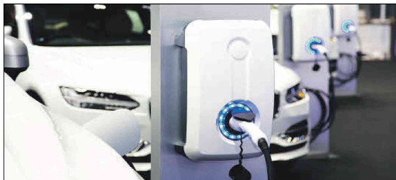
Puntos de recarga de vehículos eléctricos. EE
